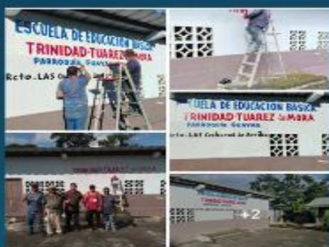
MEJORAMIENTO EEB RCTO. LAS CUCHARAS DE ARRIBA
